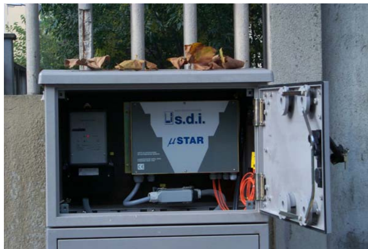
Figura 2 – posizionamento di s.d.i. μSTAR negli armadietti stradali
