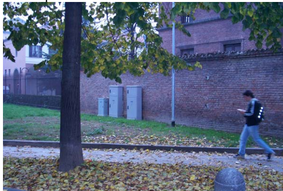
Figura 1 – Gli armadietti AEM che contengono il quadro elettrico e la RTU \mu STAR (parte superiore)
