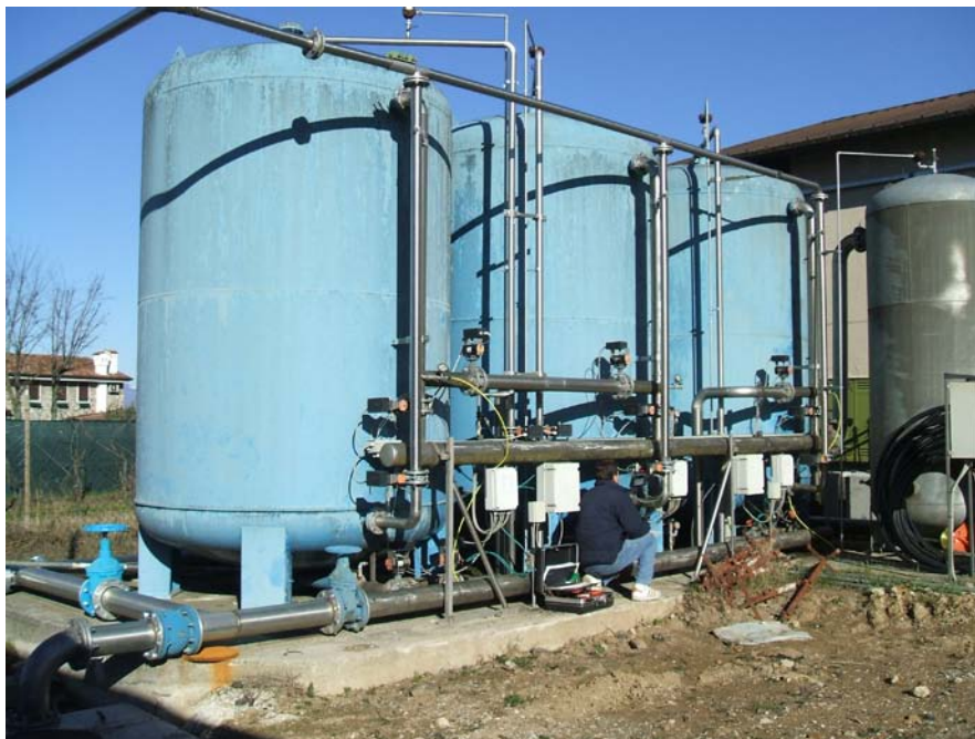
Figura 12 - Serbatoi del sistema di distribuzione acqua potabile
