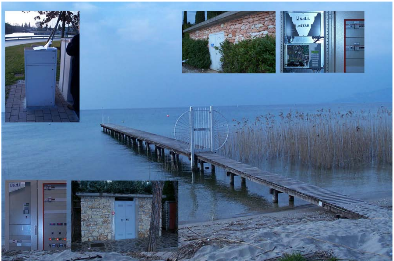
Figura 11 - Installazione di RTU presso le stazioni di pompaggio del collettore Garda EST
