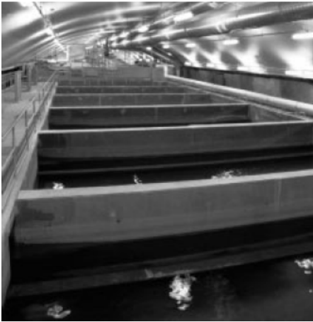
Figura 1: Filtri a sabbia dell'impianto di potabilizzazione
