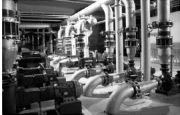
Figura 2: Centrale di pompaggio
